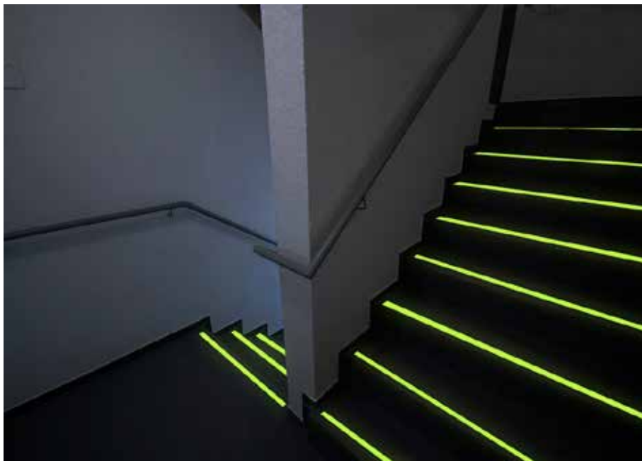
Figura 10 – Faixas Antiderrapantes Fotoluminescentes
